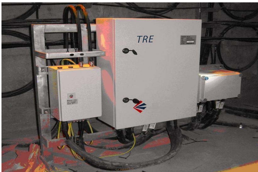
图 4-2 轨旁无线接线箱
